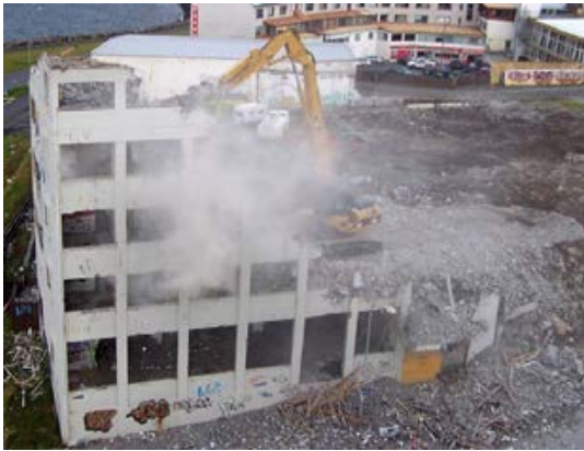
Mikil rykmengun getur verið frá niðurrifi húsa
